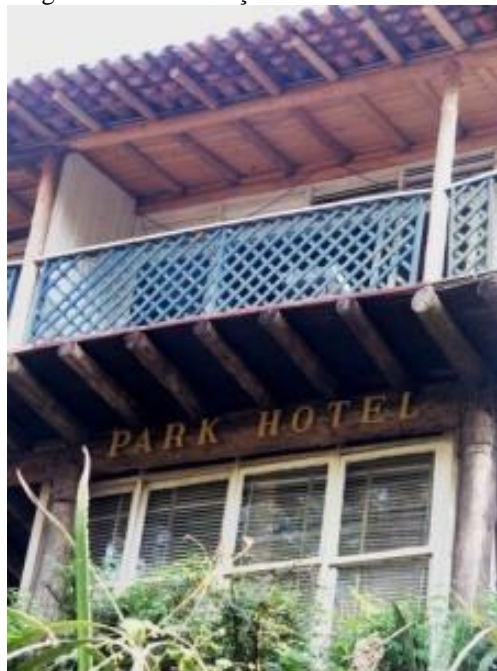
Figura 04: Deterioração da fachada do Hotel
