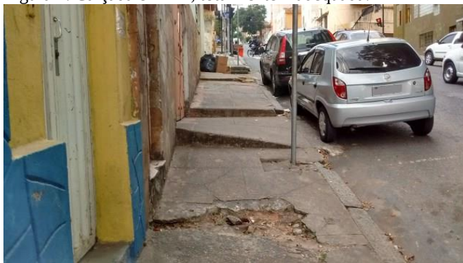
Figura 1. Calçada em BH, totalmente inadequada.
