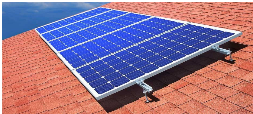
Imagem 1: Paine Solar Fotovoltaico
