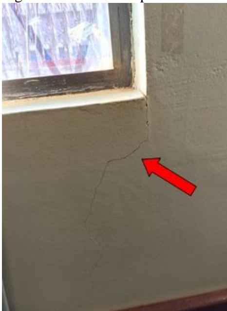
Figura 5: Fissuras em paredes.
