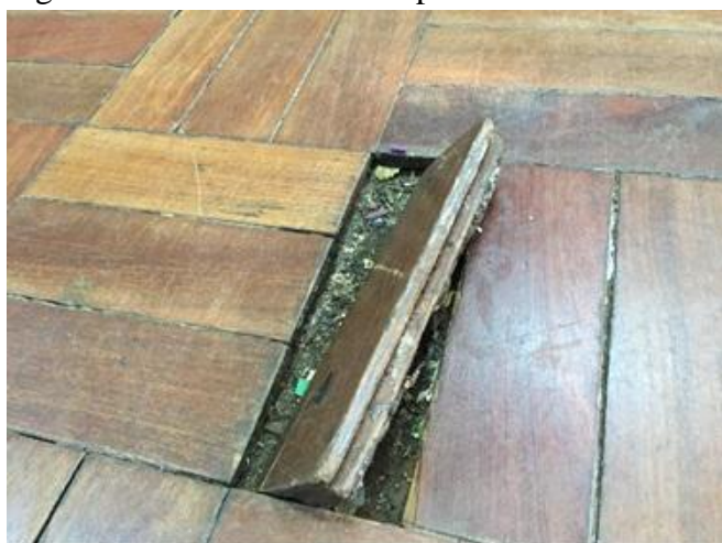
Figura 12: Descolamento do piso em taco.
