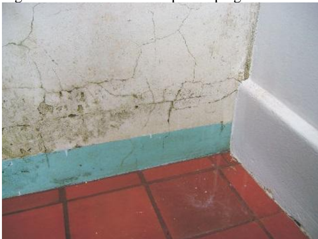
Figura 1: Manchas escuras por respingos de chuva.
