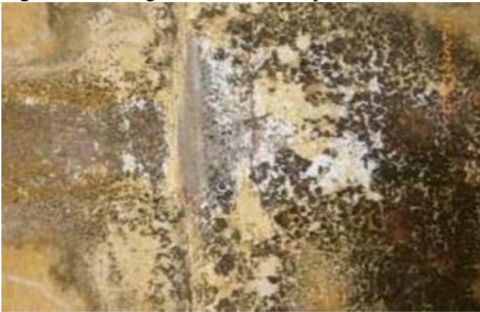
Figura 2: Patologia bolor ou mofo por conta da umidade.
