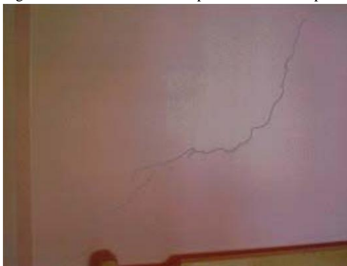
Figura 4: Fissura inclinada em parede transversal por movimentação térmica da laje de cobertura.
