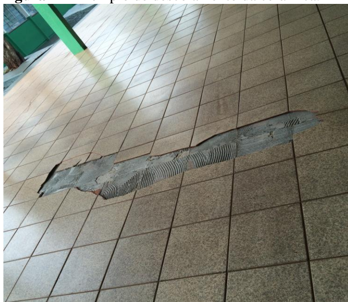
Figura 7 – Exemplo de descolamento da cerâmica.
