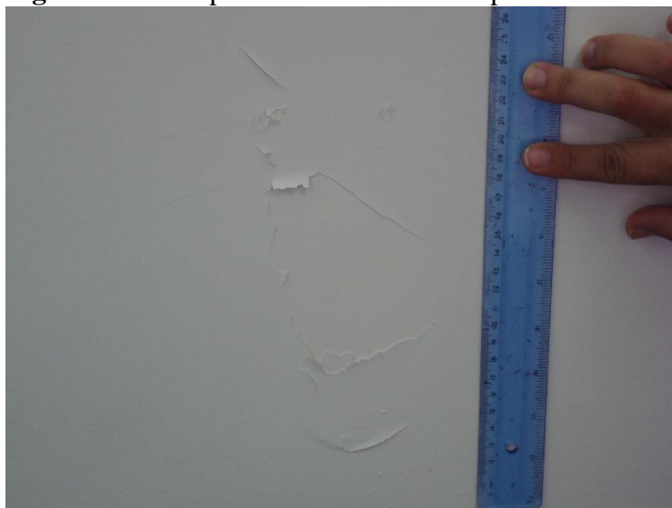
Figura 8 – Exemplo de descolamento da pintura.
