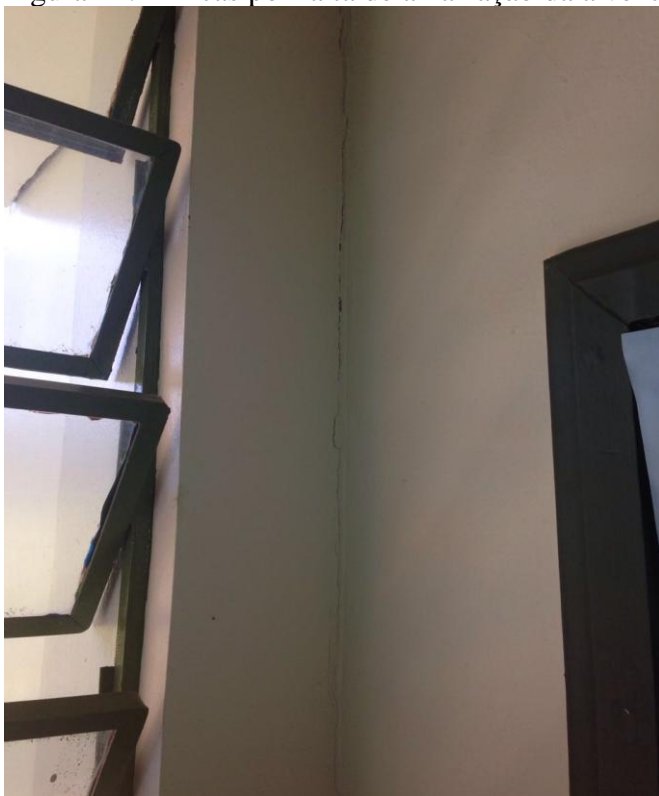
Figura 12: Trincas por falta de amarração da alvenaria
