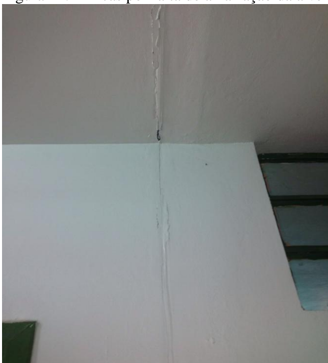
Figura 11: Trincas por falta de amarração da alvenaria
