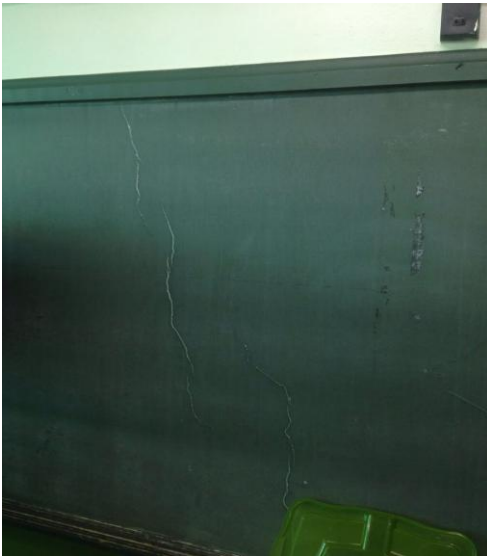
Figura 7: Fissura vertical ocasionada por sobrecarga na parte central do quadro.
