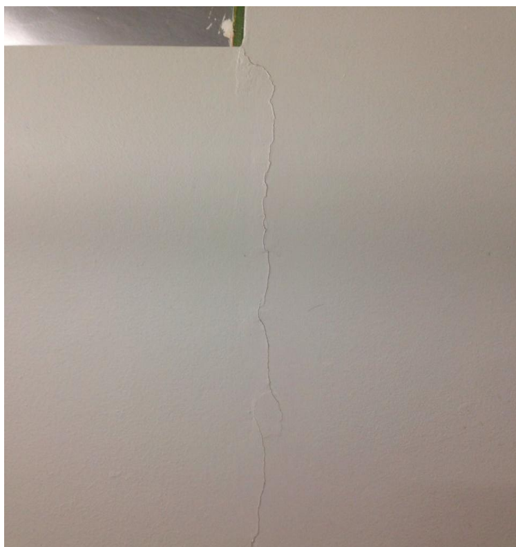
Figura 6: Fissura vertical ocasionada por sobrecarga ao lado direito, inferior da janela.
