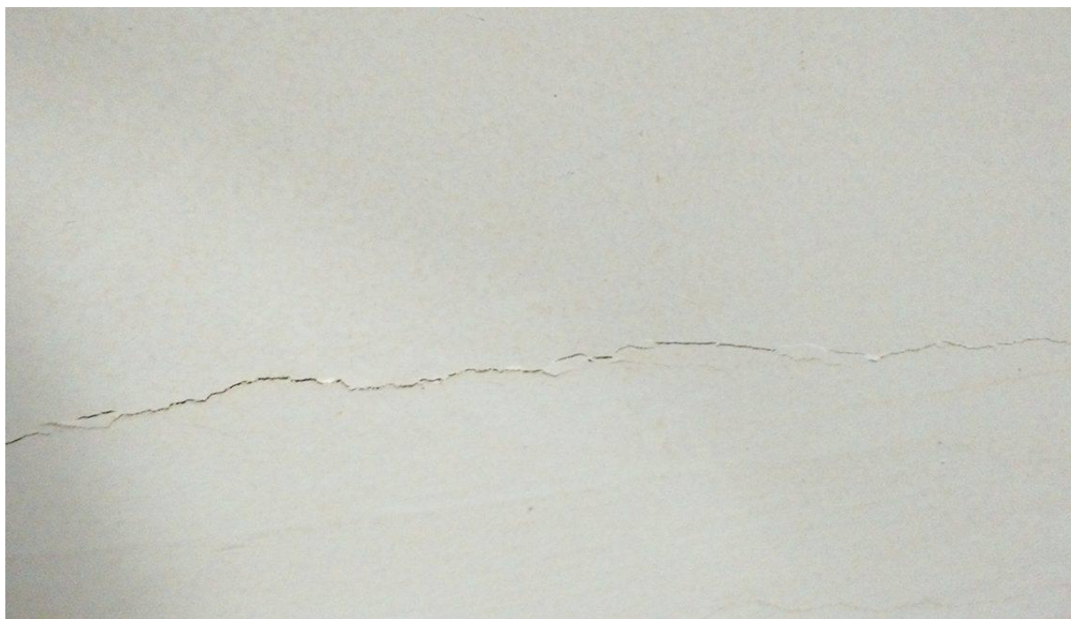
Figura 3: Fissura da Tinta.
