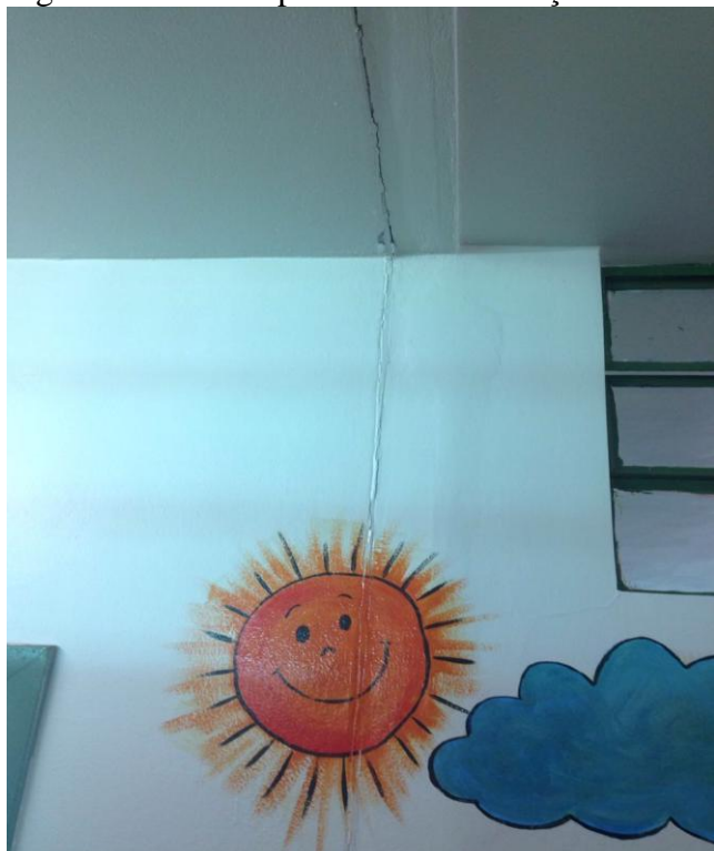
Figura 10: Trincas por falta de amarração da alvenaria
