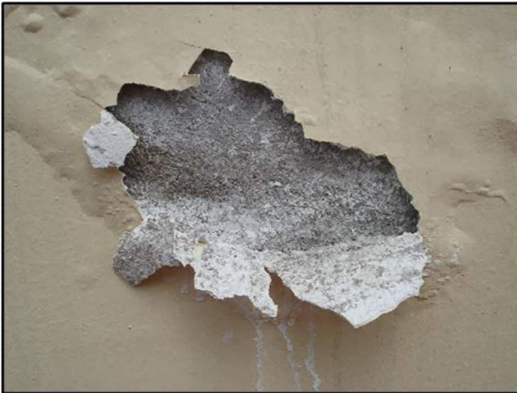
Figura 2: Eflorescência e Deslocamento da Pintura.
