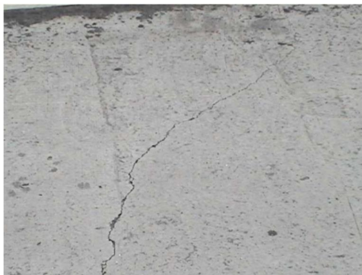
Figura 2 – Fissura Fonte: IPR (2004)
