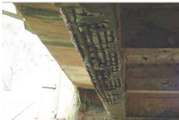
Figura 3 – Corrosão da armadura Fonte: IPR (2004)
